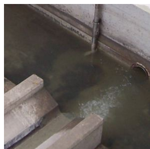
Măsurarea nivelului cu NivuBar Plus în rezervorul de deversare a apei pluviale
