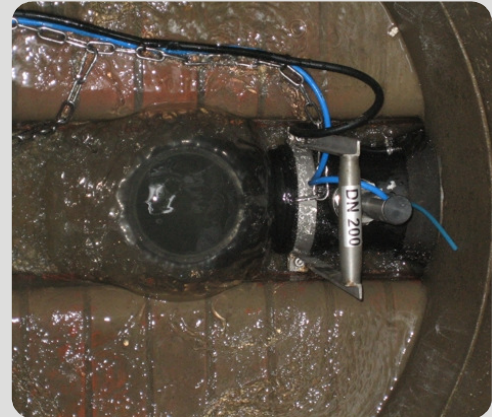
Sistemul de măsurare temporar instalat
